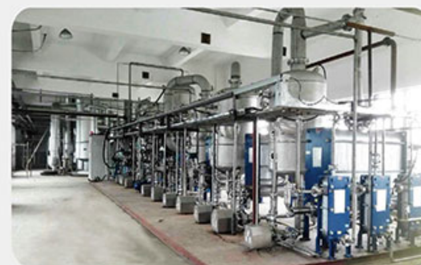
上海40th纤维素分解液板式蒸发浓缩
