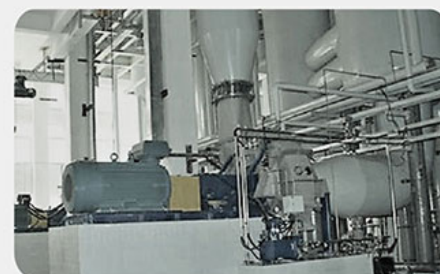
内蒙古40th硫酸铵MVR管式蒸发浓缩
